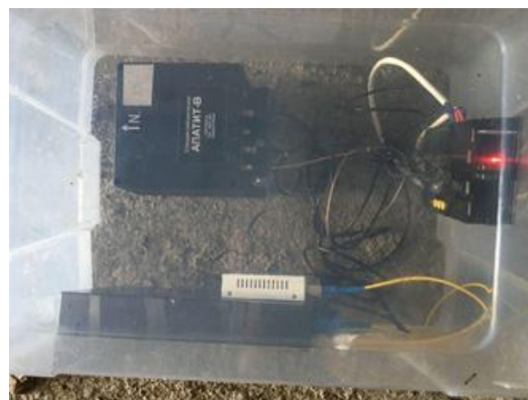
Рис. 3. Комплектация установленного оборудования
